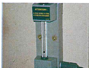
Traitement Chlore gazeux
