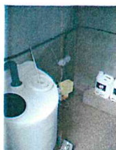
Traitement Pompe doseuse de chlore
