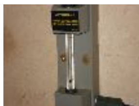
Traitement Chlore gazeux
